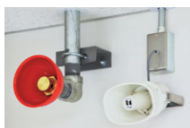
ガス消火システム
