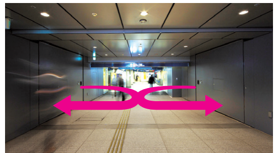
防水扉 (地下コンコース連絡口)
